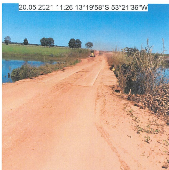
FOTO 24: DETALHE DE PONTE DE MADEIRA A SER SUBSTITUÍDA POR PONTE DE CONCRETO - km 21,4
