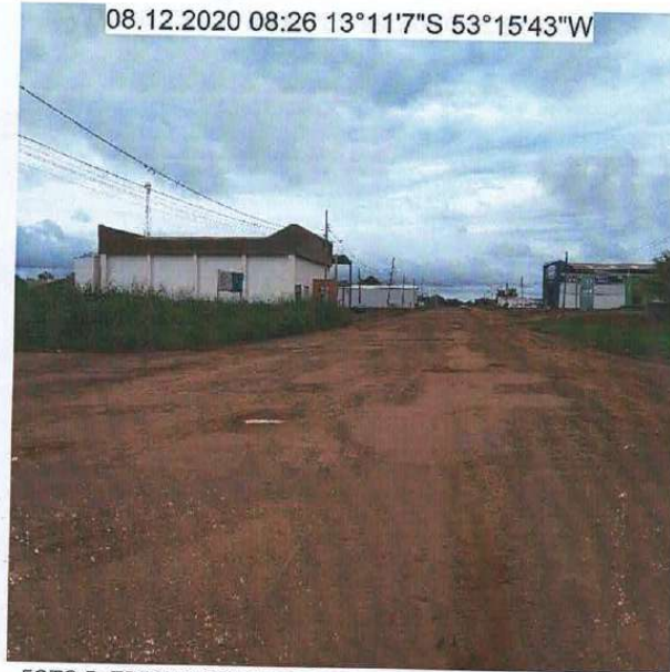
FOTO 5: TRECHO COM TSD ANTIGO, COM MUITOS BURACOS, NO P. U. DE GAÚCHA DO NORTE - km 0,3
